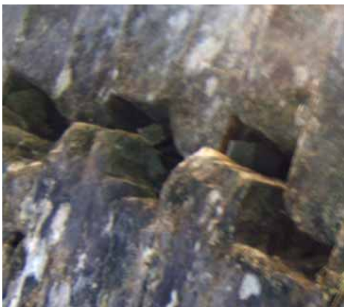
Le fenditure nella volta del ponte
